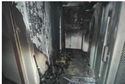
Så här förstört blev ett trapphus efter en barnvagnsbrand.
